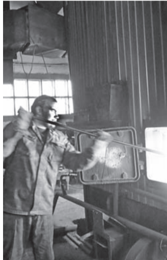
Новый котёл в котельной с. Старое Татаурово.
